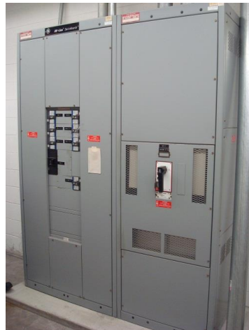
MDP-1P (Sub-Basement Electrical Room)
